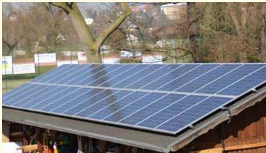
Mit diesen Kollektoren auf dem Dach des Wirtschaftshofes produziert der Tierparkverein seit 2014 Strom. Der Großteil wird gleich vor Ort verbraucht.
